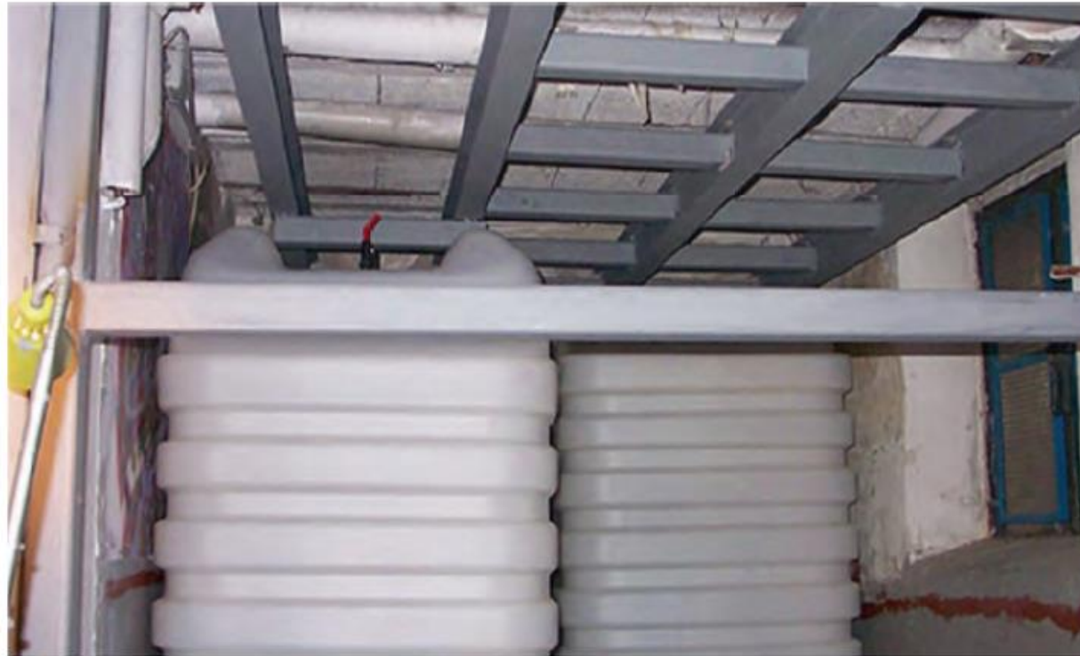
Gegen Auftrieb gesicherte Heizölanlage
