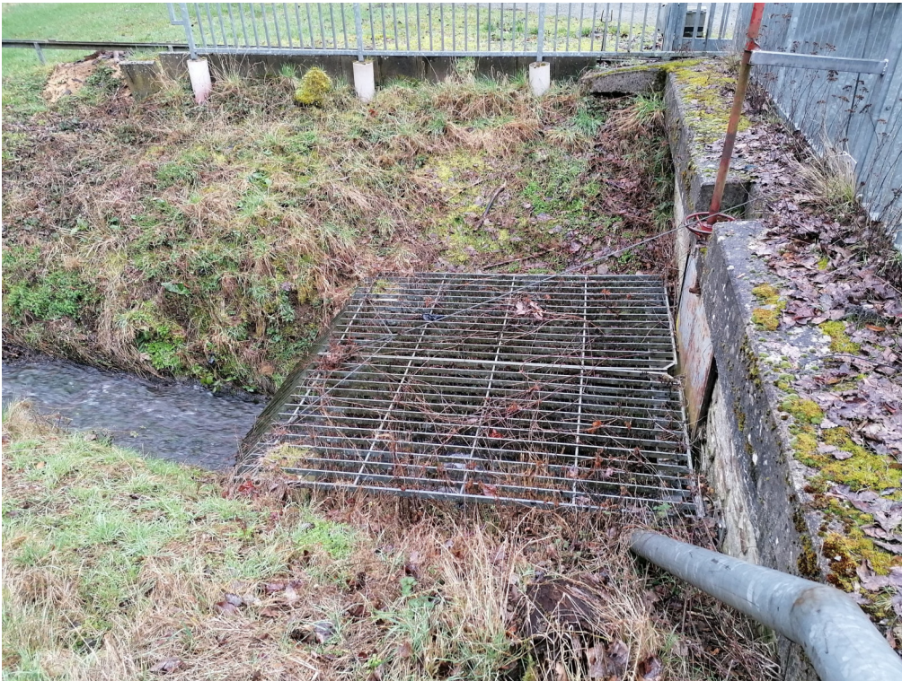
2D Rechen vor Gewässerverrohrung des Erlenbach
