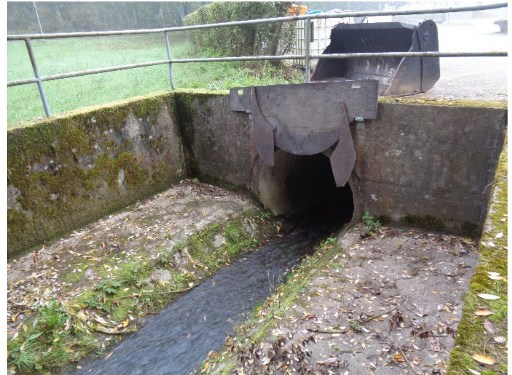
Beginn der Verrohrung Weinbach, 3D Rechen in 2024
