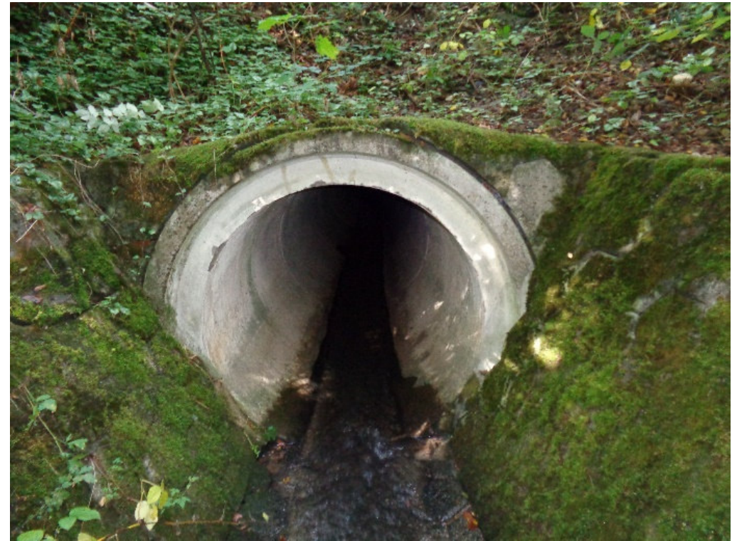
3D Rechen vor Gewässerverrohrung des Weinbaches (Festplatz)
